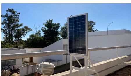
Fig. 5. Painel fotovoltaico na estrutura.
